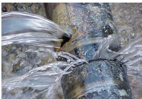
Рис. 4.30. Потери воды на магистральном водопроводе
